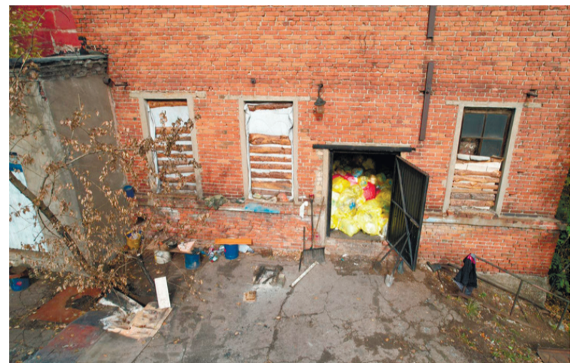
Отсутствие контроля санитарного состояния площадки
